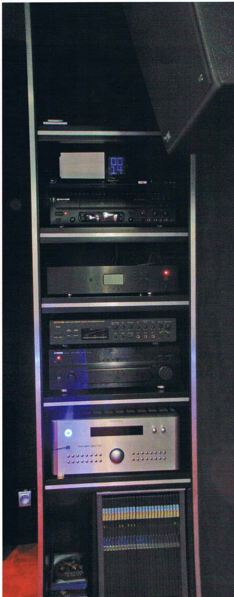
Jacques ne voulait pas de rack. L'installateur a donc créé un meuble sur mesures avec un double fond pour cacher les câbles.
